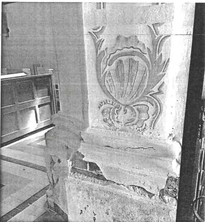
fol. 15. Odkrywka stratygraficzna na pilastrze w nawie kościoła z widoczną marmoryzacją oraz zdegradowana zaprawą w strefie cokołu
